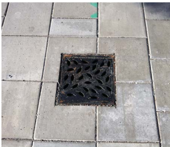
Galler för avrinning av dagvatten
