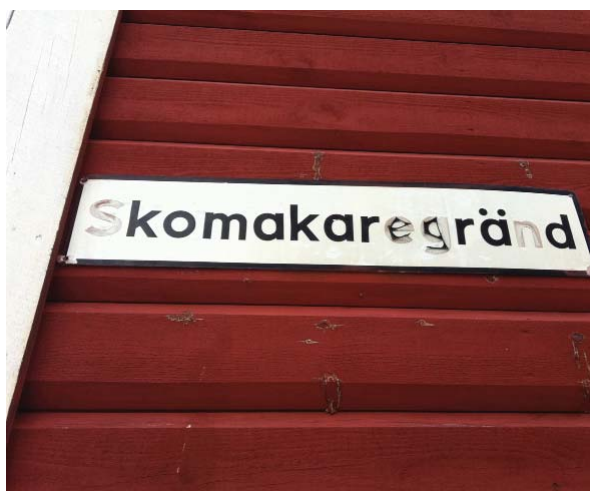
Denna typ av skylt bör inte användas på grund av dålig hållbarhet
