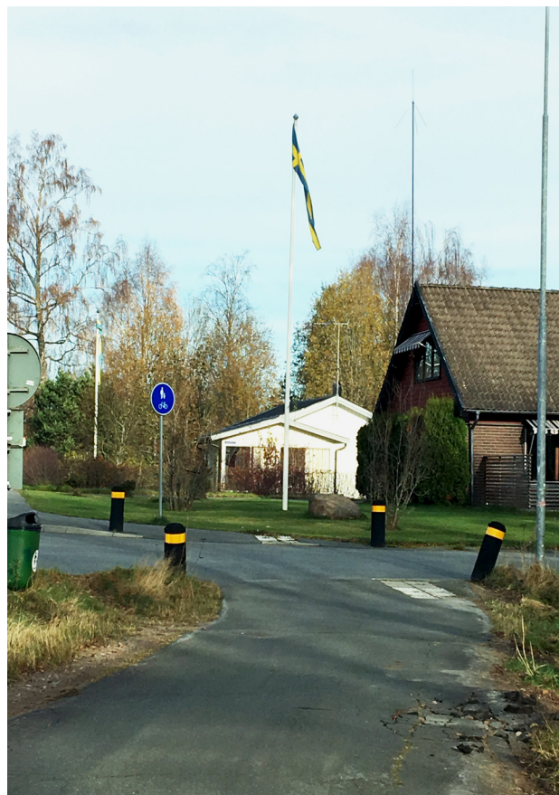
GC-väg i Hult. Sprickor och Pothål, sneda pollare.
