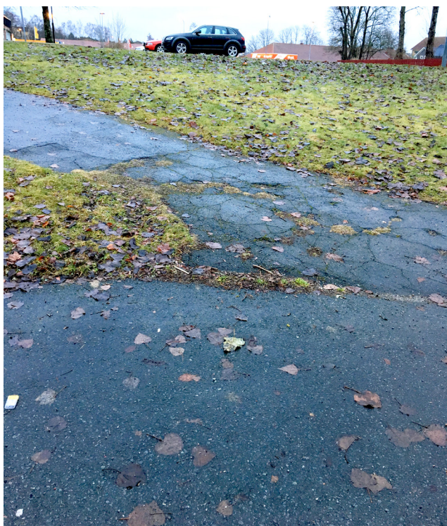
GC-väg i dåligt skick utanför Prästängsskolan.
