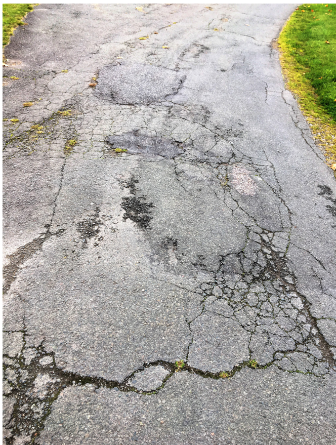
Sprickor och ojämnheter i GC-vägar som försämrar framkomligheten och komforten.
