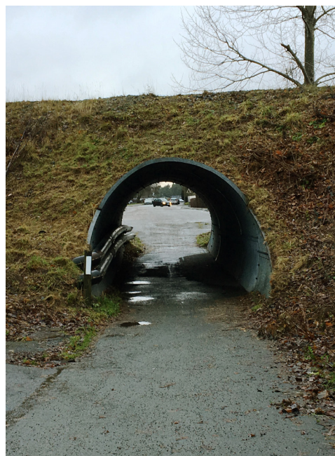
Tunnel där trygghet kan förbättras, under järnväg
